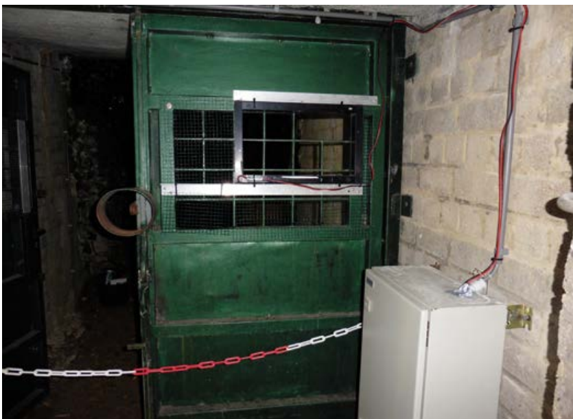
◀ FIGUUR 7 Het telraam in de toegangsdeur. De openingen in de toegangsdeur zijn afgedicht met gaas, behalve die binnen het telraam (de zwarte rechthoek). Rechts van de kast met elektrische voorzieningen (foto: H. Weinreich).
